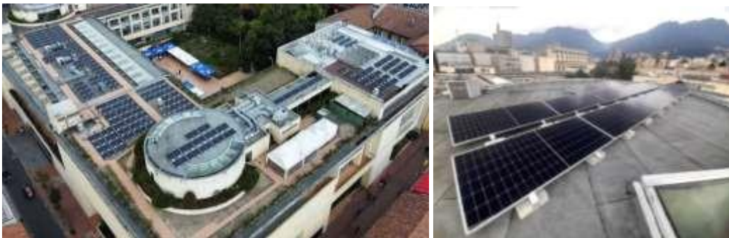
Ilustración 2. Paneles solares distribuidos en estructura de techo.
