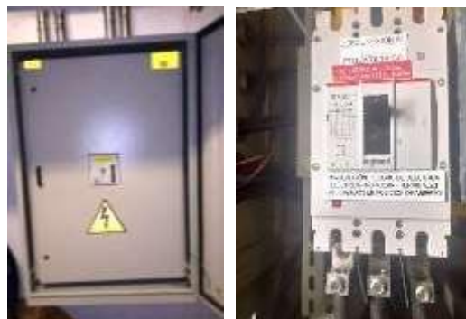
Ilustración 3. Tableros de conexión FV y punto de conexión subestación
