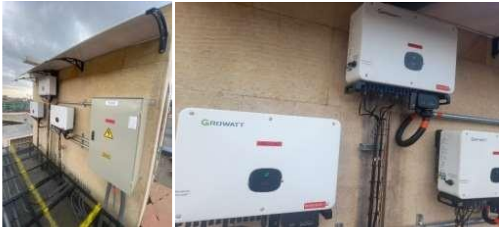
Ilustración 1. Inversores Growatt y tablero de distribución PV
